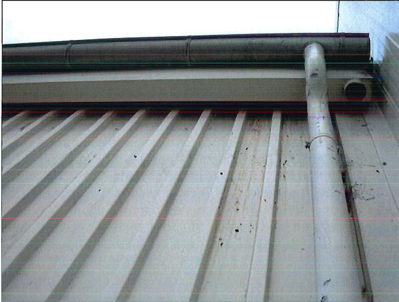
Abbildung 3: Die in den ungedämmten Dachkästen der Glasfaserproduktionshalle des Betonwerkes nistenden Dohlen ( Columba palumbus ) nutzen die zwischen den Blechkästen und den Stahltrapezprofilen vorhandenen Hohlräume als Einfluglöcher, s. Text (Foto: Verfasser).
